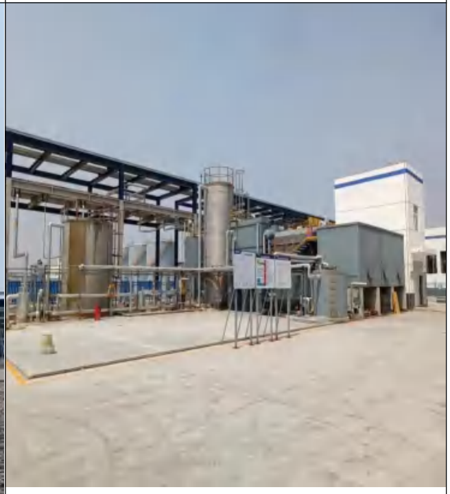
配套污水处理站
