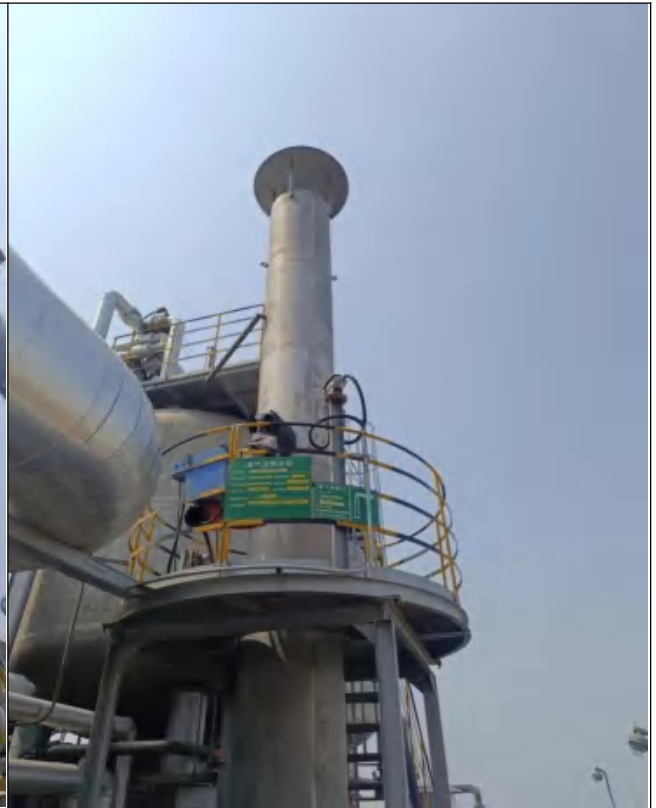
P5-2 废气排气筒
