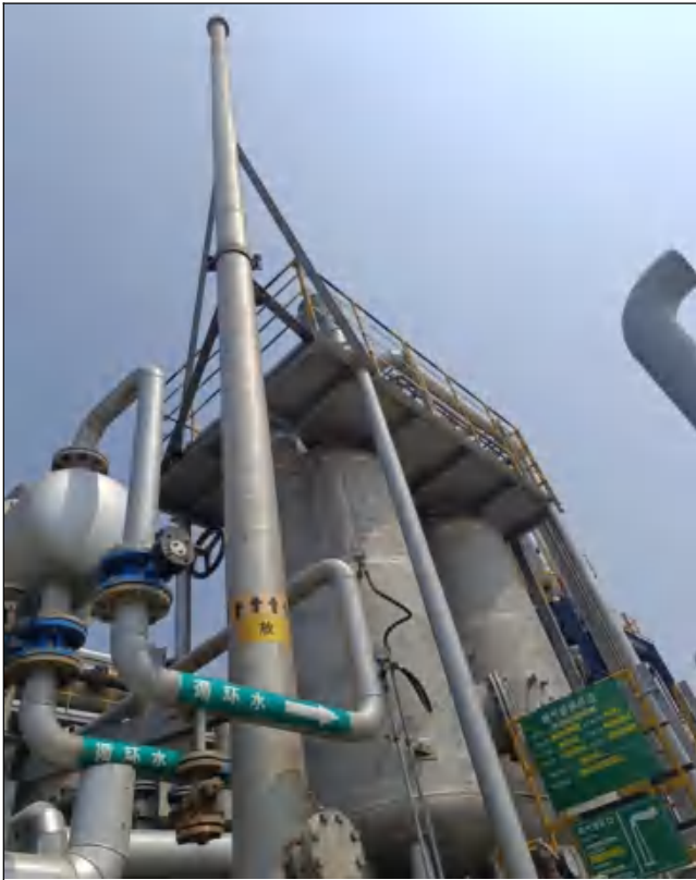
P5-1 废气排气筒
